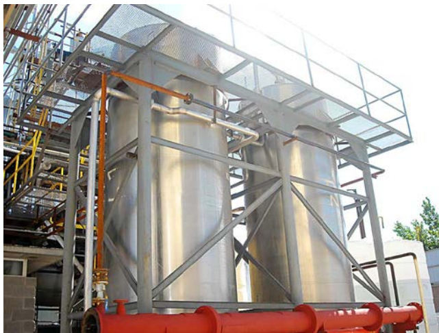
Planta de biodiesel de la empresa Biomadero S.A. en la provincia de Buenos Aires. Foto: Biomadero.
